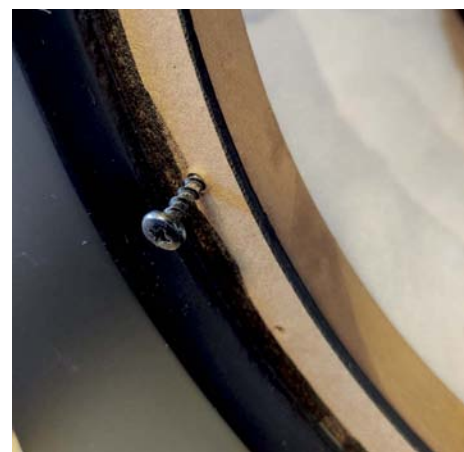
Här finns möjlighet till förbättring tycker jag, och som håller med byter ut dessa träskruvar till maskinskruv och islagsmutter!
